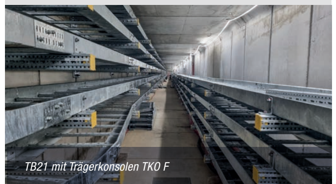
siFramo Supports im Tokamak Gebäude
